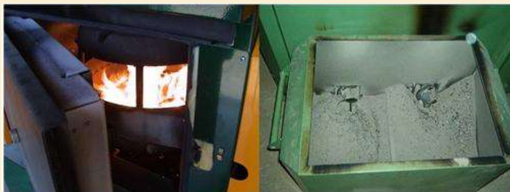
Caldera de Biomasa en funcionamiento y contenedor con cenizas. Foto Junta de Castilla y León.
